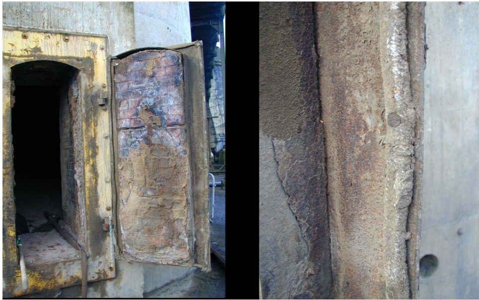
Fotografía 4.12 Cuerda de amianto que sella la puerta de una chimenea. La imagen de la derecha muestra la cuerda de cerca.
