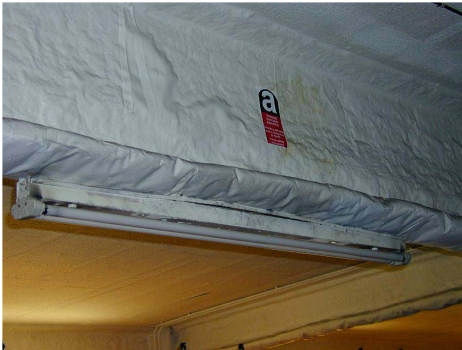
Fotografía 4.11 Aislamiento de amianto en una estructura de acero.
