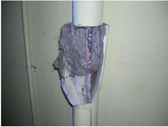
Fotografía 12.7 Aislamiento de una tubería con múltiples capas de amianto y penetración del agente humectante.
