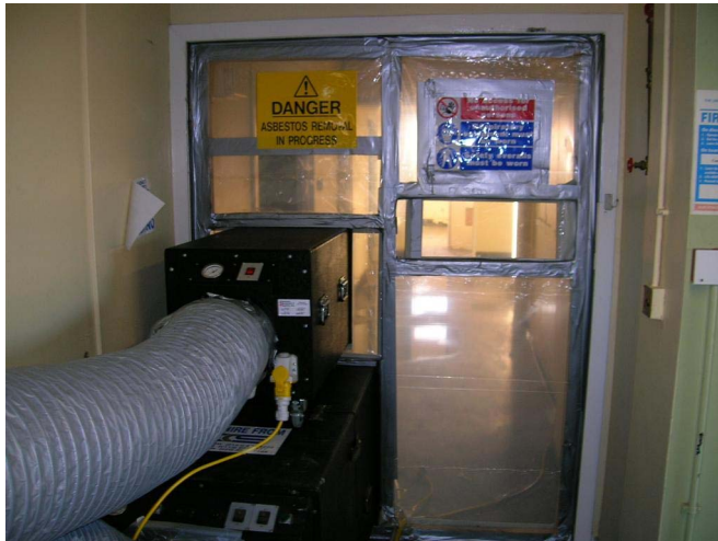
Fotografía 12.2 Sistemas de depresión y conductos de evacuación del aire, ventanillas y señales de advertencia.
