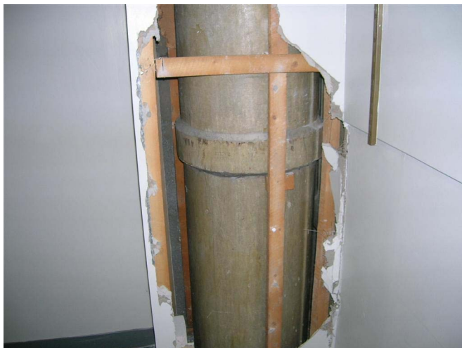
Fotografía 4.2 Caja de tablero aislante de amianto parcialmente retirada para mostrar el conducto de evacuación de humos de fibrocemento que esconde en su interior.
