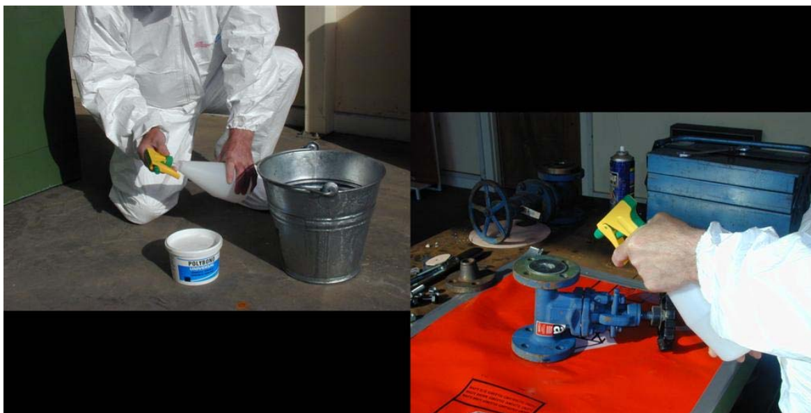
Fotografía 11.4 Humectación de una junta de amianto de la válvula.
