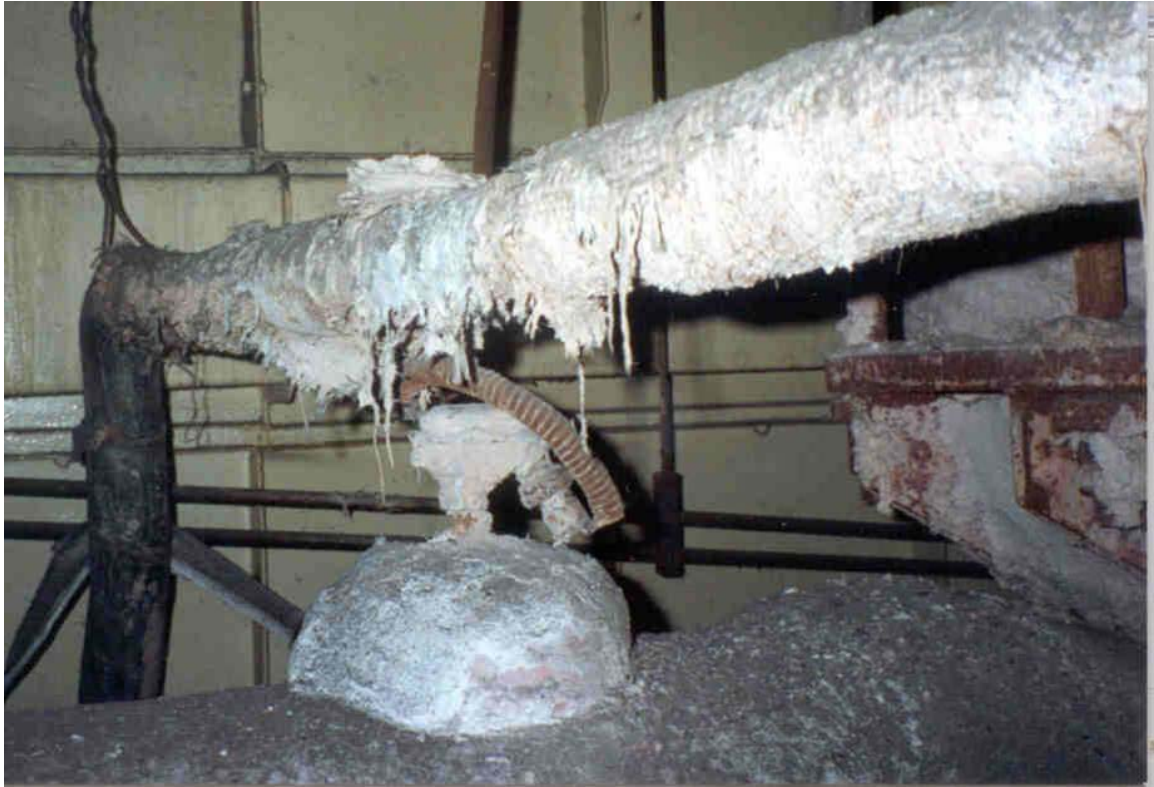
Fotografía 4.8 Aislamiento de amianto en tuberías de vapor.
