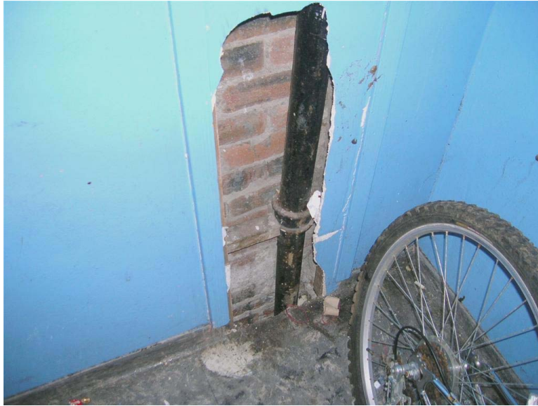
Fotografía 6.4 Tablero aislante de amianto; se debe considerar su retirada, ya que, por su ubicación, puede sufrir daños.
