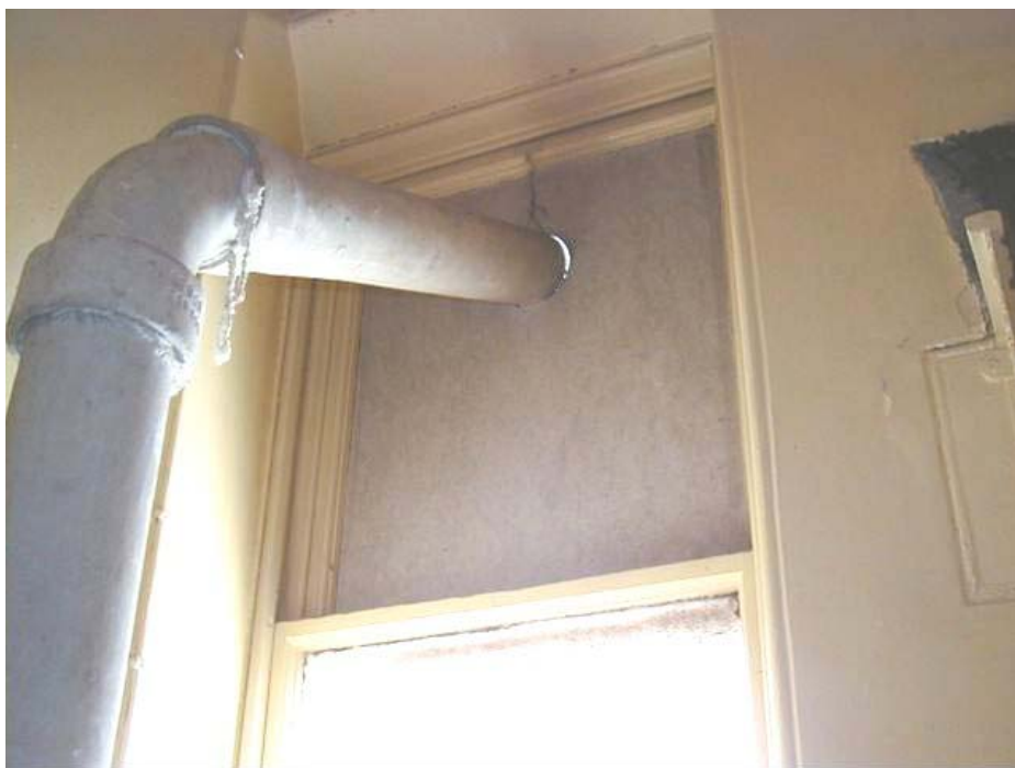
Fotografía 4.5 Conducto de evacuación de humos de fibrocemento sellado con cuerda de amianto que pasa a través de un panel de relleno de amianto.
